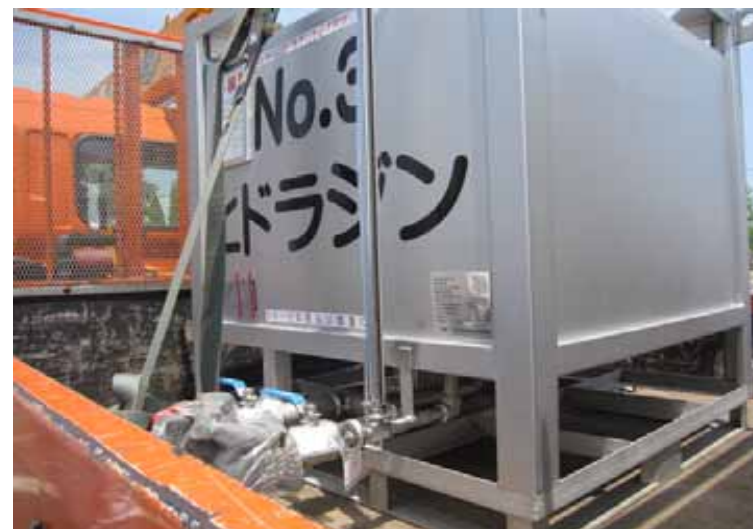
ヒドラジン注入設備：写真は車上の薬液タンク
