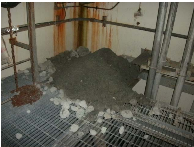
⑤流入痕（天井貫通部下の土砂）
