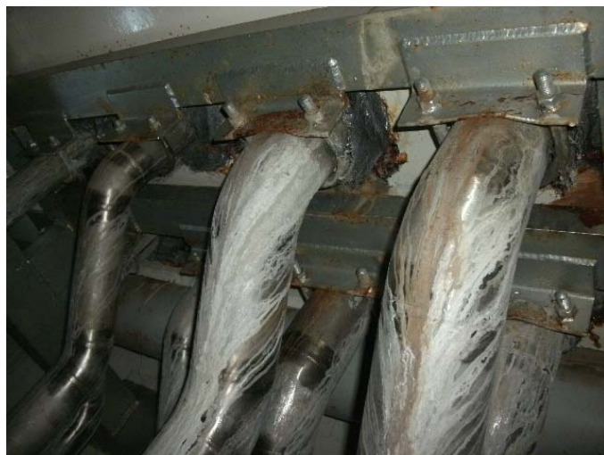
②流入痕（天井貫通部）
