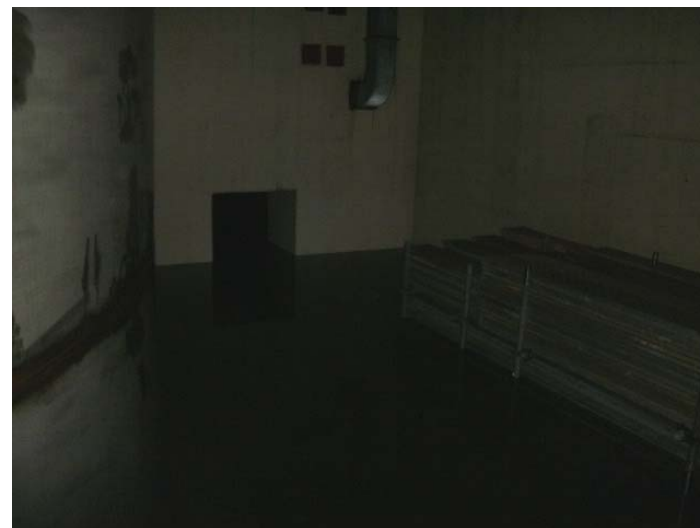
①溜まり水の状況
