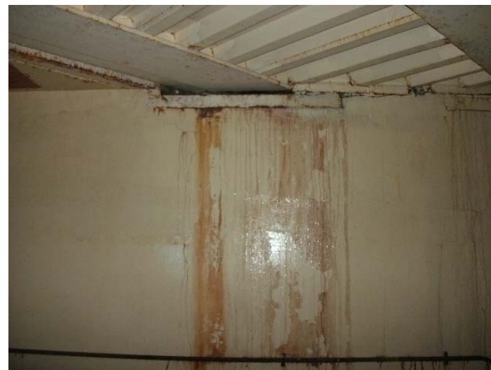
④流入痕（天井・壁交差部）
