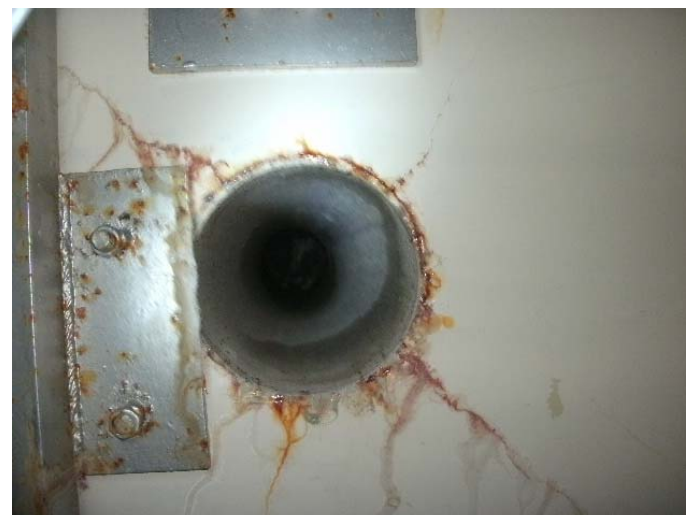
⑥流入痕（土砂上の天井貫通部）
