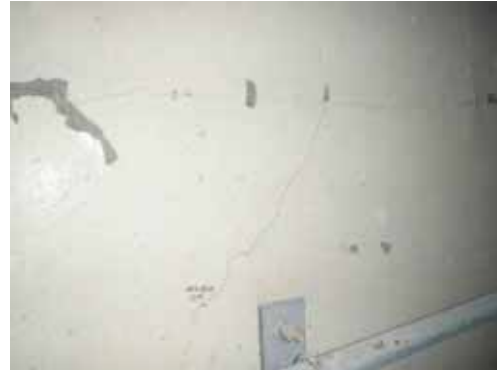
② 2階 西3-西4間外壁内面 (ひび割れ幅 0.3mm)
