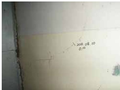
① 2階 西2-西3間外壁内面 (ひび割れ幅 0.1mm)
