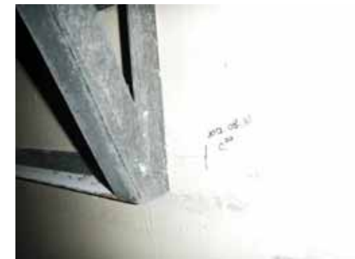
③ 2階 西4-西5間外壁内面 (ひび割れ幅 0.2mm)
